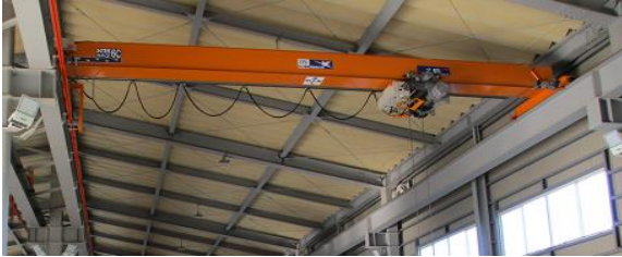
[2, 8ton天井クレーン]
